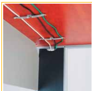
vedení kabeláže > pod deskou pokračuje uvnitř nohy až k zemi
